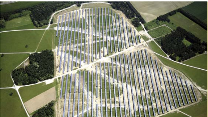
Photovoltaikanlage, Pocking, Niederbayern
