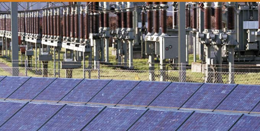
Umspannwerk mit kleinem Solarkraftwerk, Bonn
