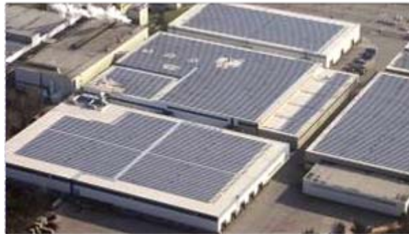
Michelin, mit 9 MWp weltweit größtes Aufdachprojekt
