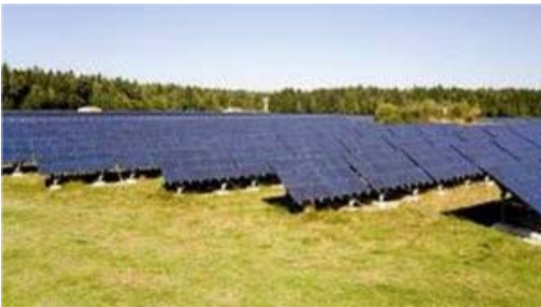
4 MWp in Hemau auf ehemaligem militärischem Gelände
